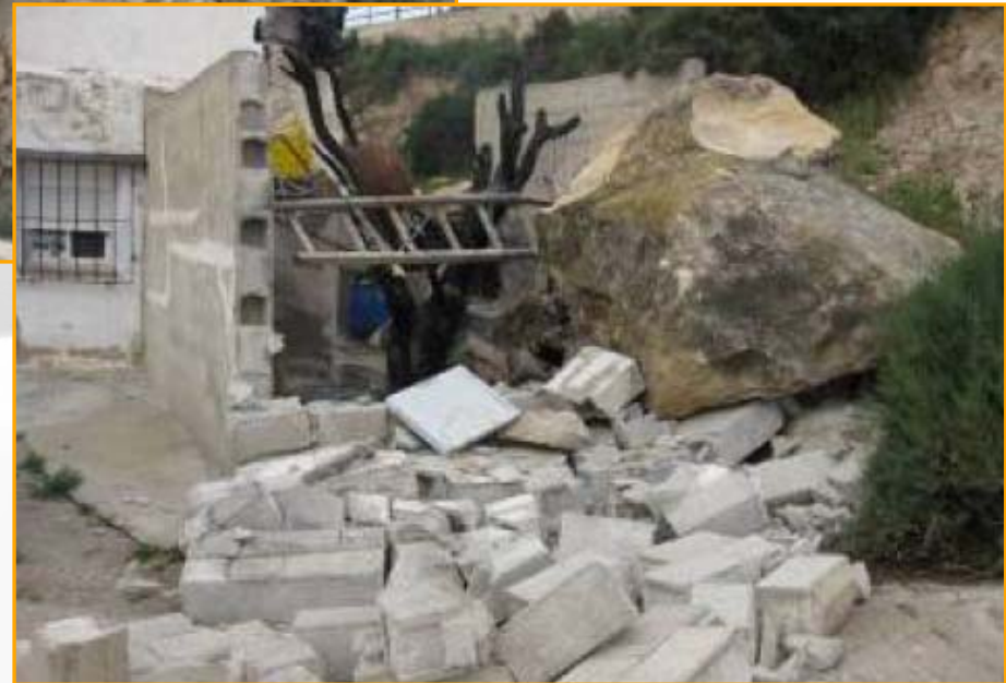
Desprendimiento de roca del Espolón
