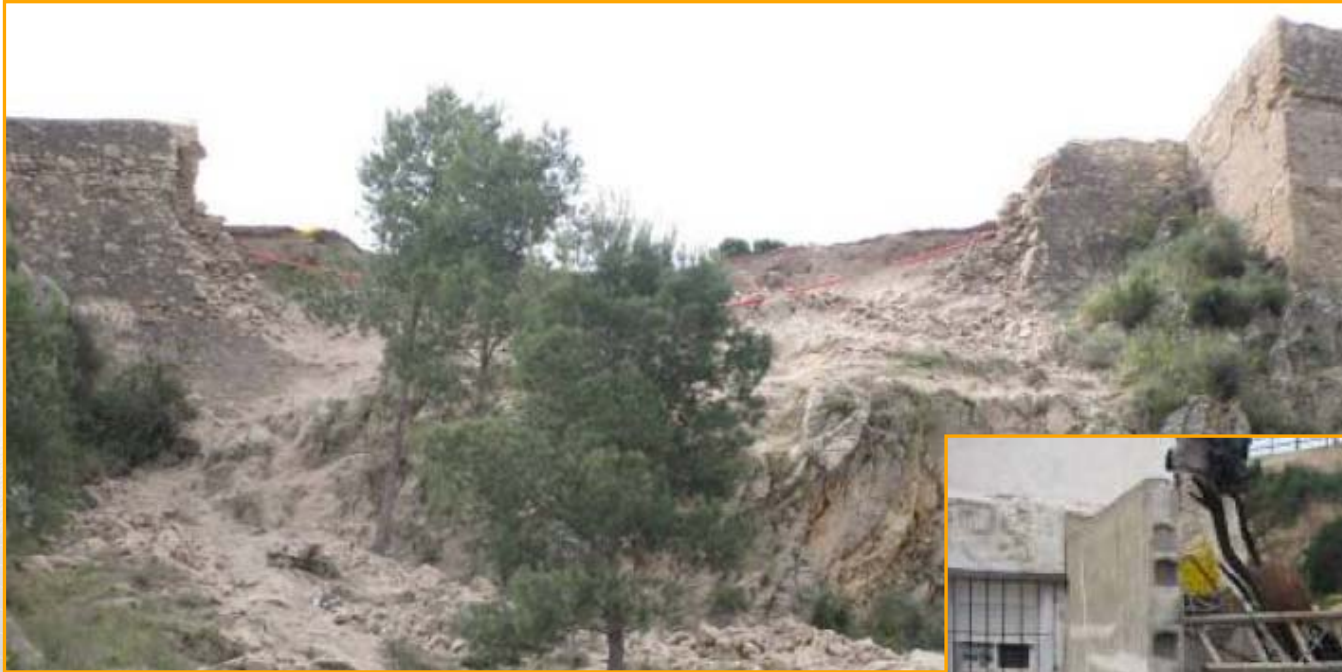
Colapso de la muralla del Castillo
